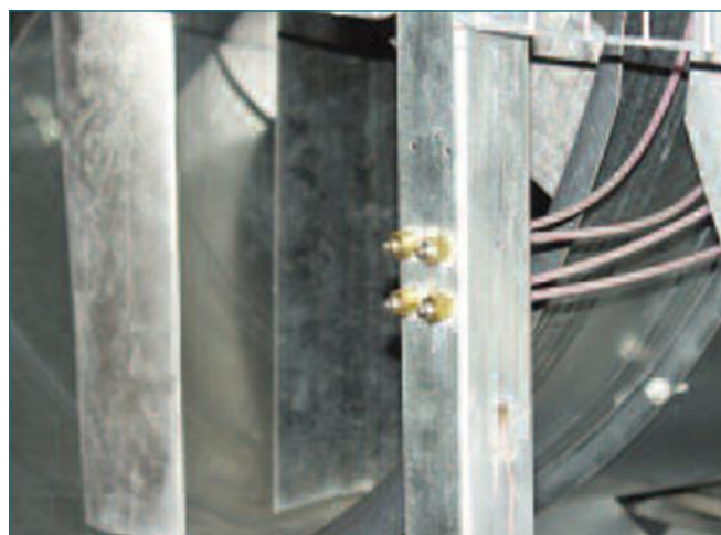
Figura 2B. Conexões e tubos de Nylon da linha SLM para lubrificação
